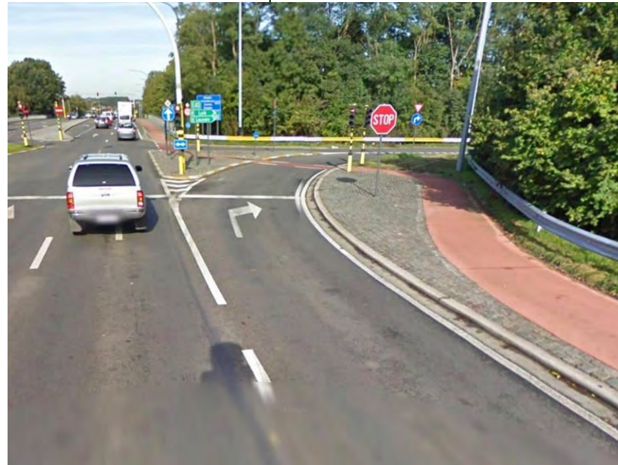
Nassegem, N227: fietsoversteek van de bypass beveiligd door fietslichten met drukknoppen Bron: Google streetview.
